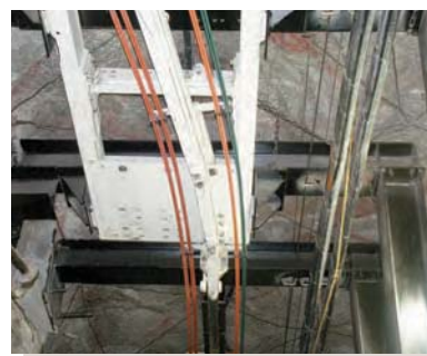
Bányában elektromos szállítóeszközök betáprendszerei
